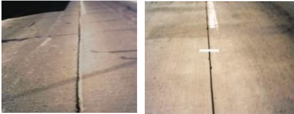
Imagen 11: Separación de la junta longitudinal
