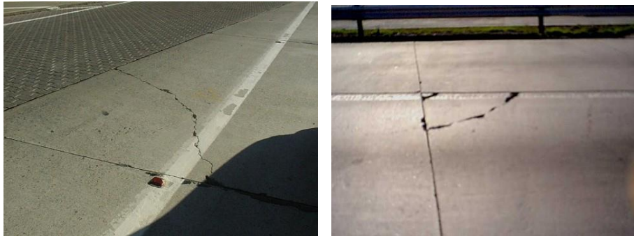
Imagen 12: fisuras y grietas de esquina
