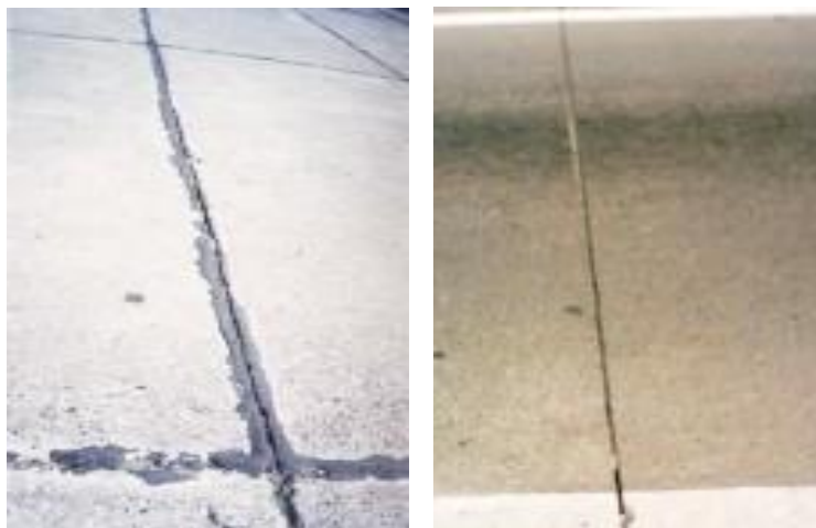
Imagen 9: Juntas y deficiencias en sellados
