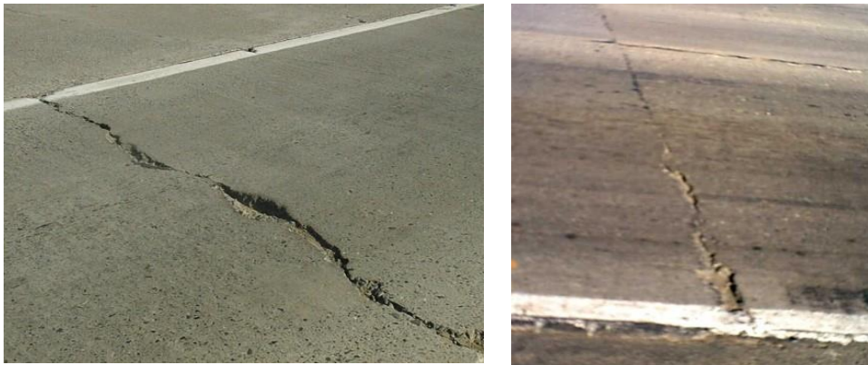
Imagen 10: Juntas y grietas saltadas
