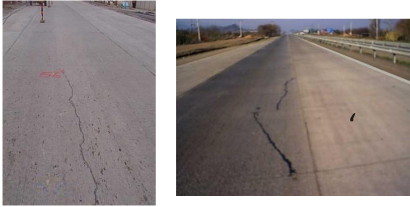
Imagen 13: Fisuras y grietas longitudinales
