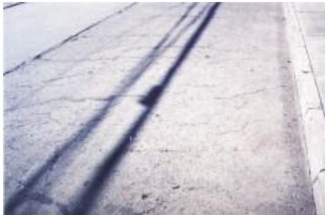
Imagen 15: Fisuramiento por retracción
