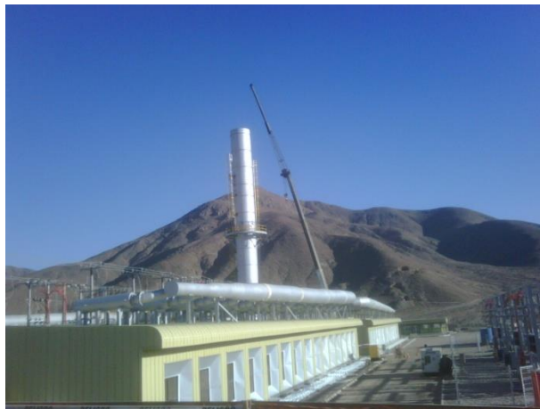
Fig. 3-1 Manifold descarga gases producto de la combustión (450°C).
