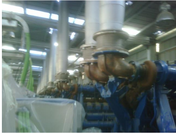
Fig. 3-6 Descarga de un generador Diesel a 450°C (recomendada por el fabricante).
