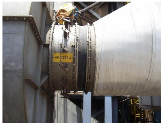
Fig. 3-5 Junta en un ventilador.
