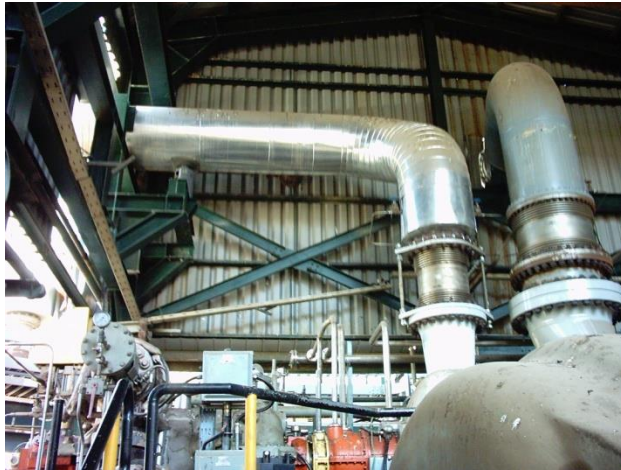
Fig. 3-3 Junta metálica instalada en succión y descarga de compresor de aire.
