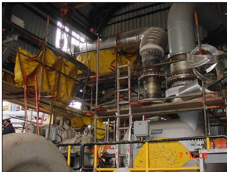
Fig. 10-3 Juntas en succión y descarga de compresor de aire.
