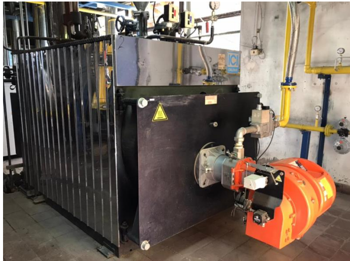
Caldera N°2, de Vapor Caliente y Quemador.
