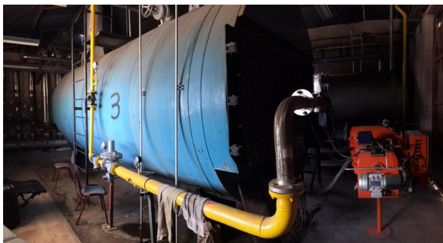
Caldera N°3, de Vapor Caliente y Quemador.
