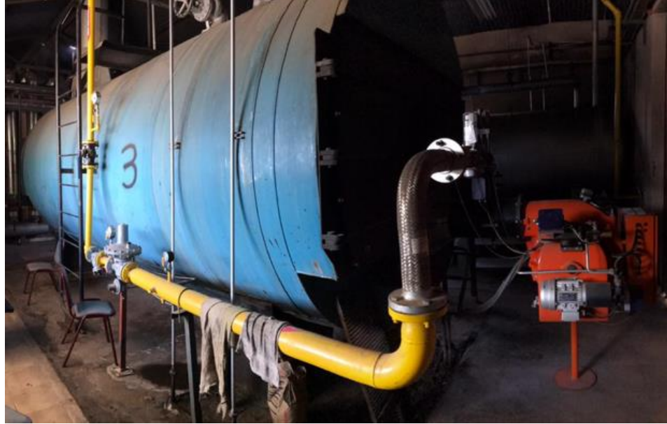
Fuente: Caldera N°3 y quemador, central térmica Hospital de Los Andes.
