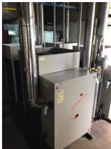
Figura VII: (1.7) Caldera N°1 (CA-01) generadora de agua caliente
