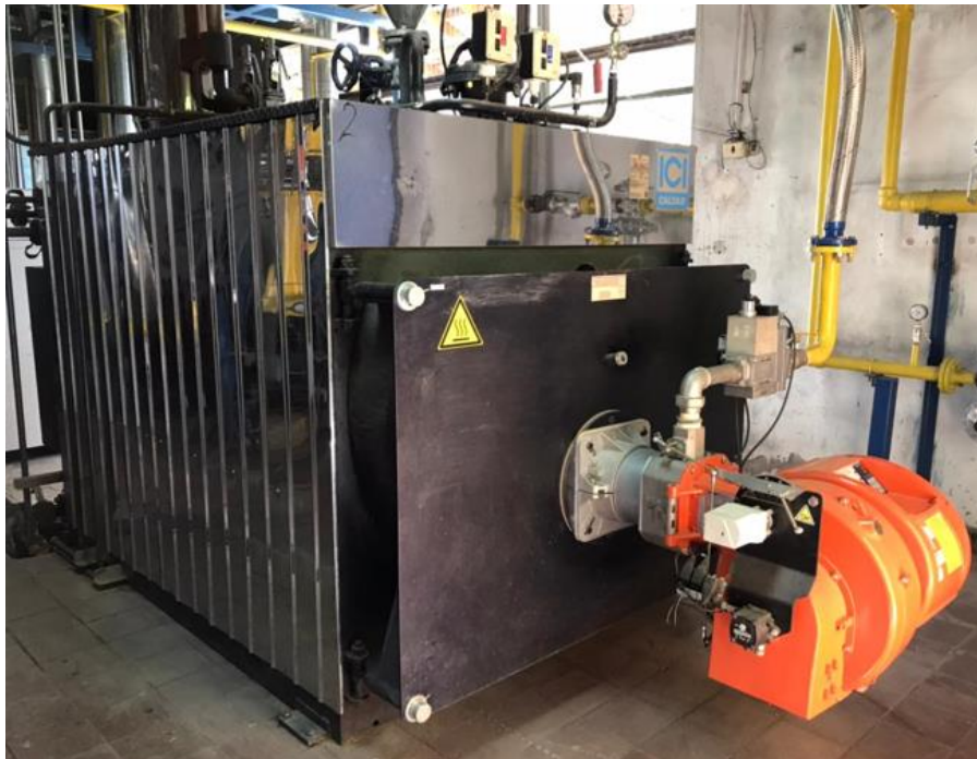
Fuente: Caldera N°2 y quemador, central térmica Hospital de Los Andes.
