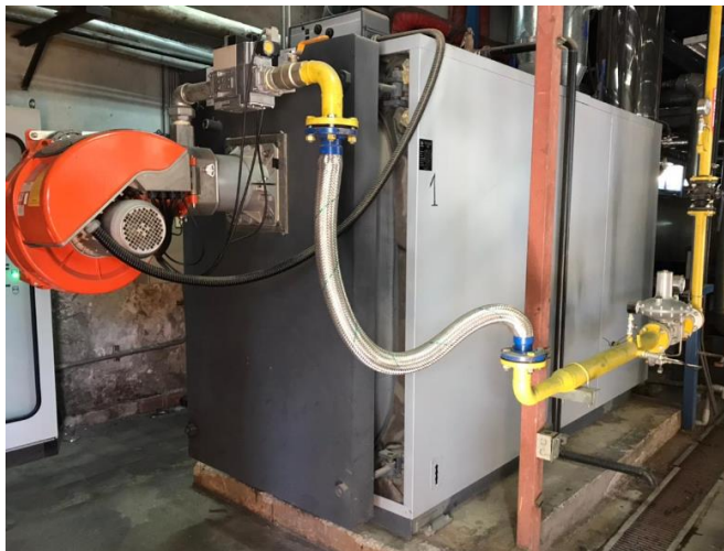
Caldera N°1, de Agua Caliente de Condensación y Quemador.
