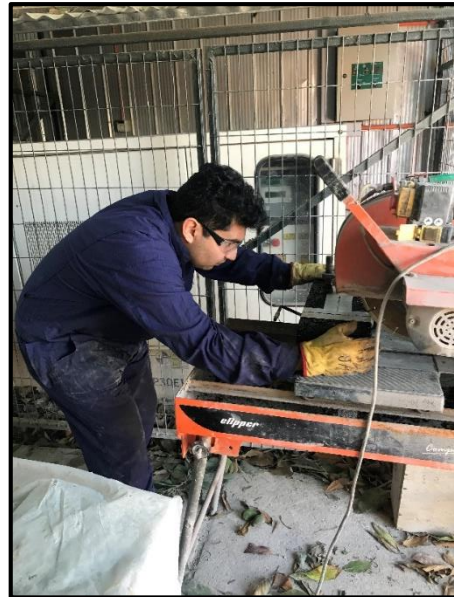
Figura 4-10: Viga siendo cortada. Elaboración Propia.
