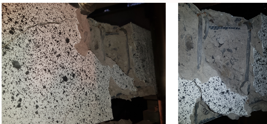
Figura 4.26: Viga 2 - Desprendimiento del hormigón e inspección de los estribos.
