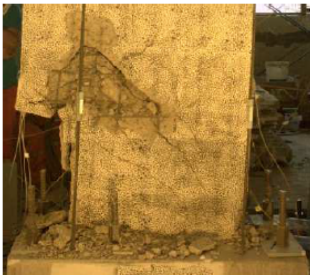
Figura 2.3: Zona de falla. Manríquez y Massone (2016) .
