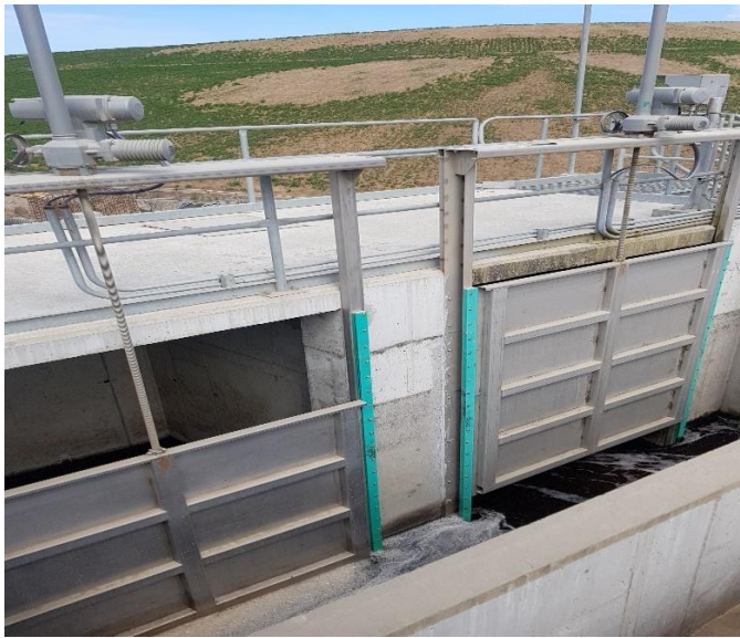
FIGURA 3.8: Tornillo sin fin en compuertas.
