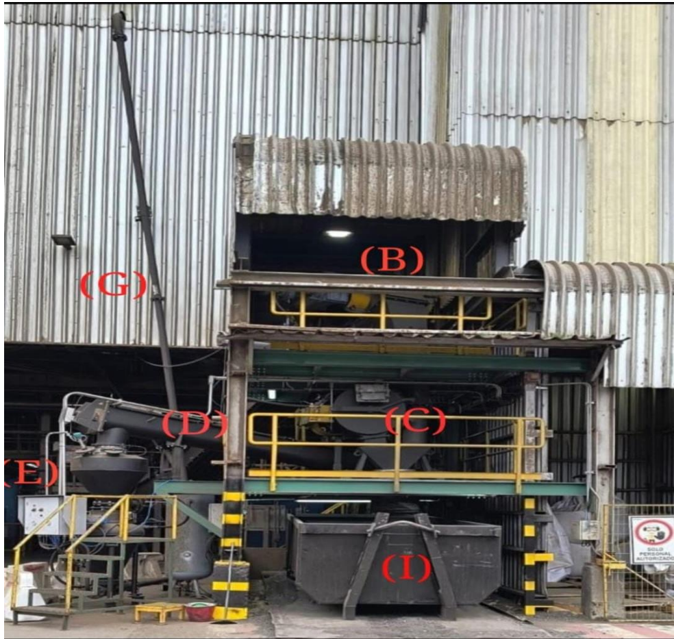
Figura 2- 13: Vista de elevación del equipo.
