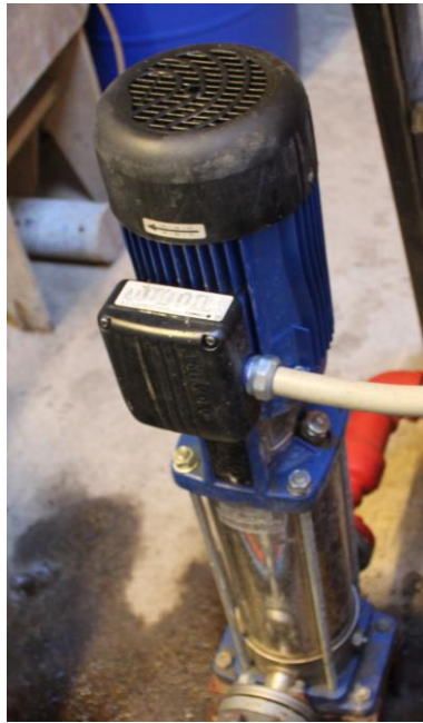
Imagen 4 motor bomba vertical
