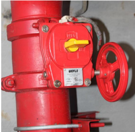
Imagen 6 válvula de control
