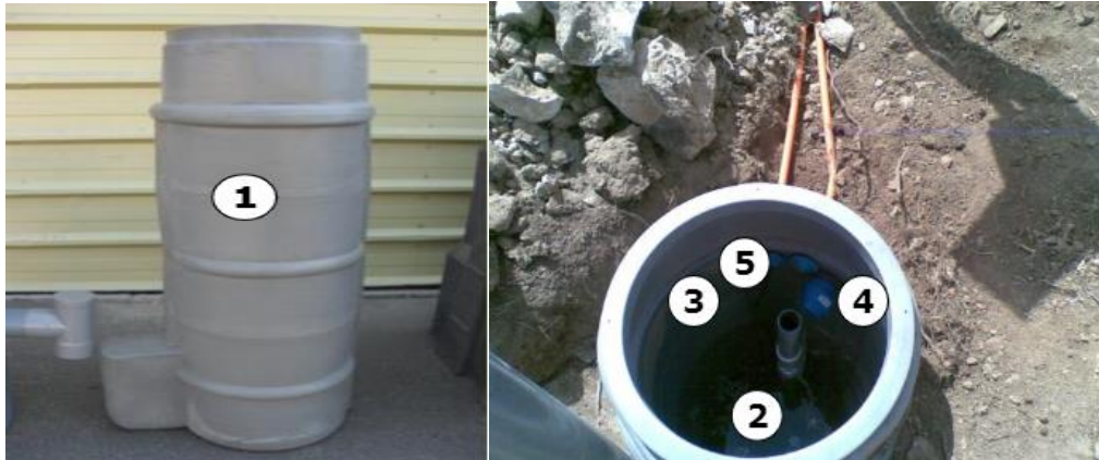
Figura 16 y 17 Componentes estación de bombeo
