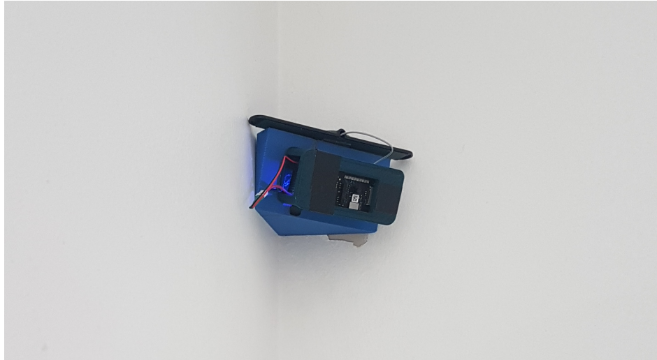
Figura 15: Portenta H7 con soportes 3D y antena de transmisión LoRa. Fuente: Elaboración propia.
