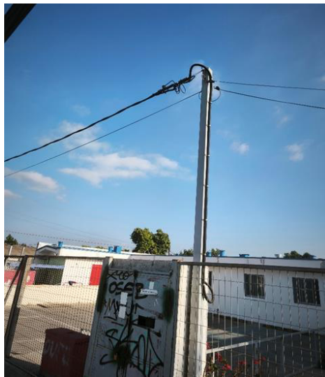
Figura 8: Empalme monofásico existente en jardín infantil.
