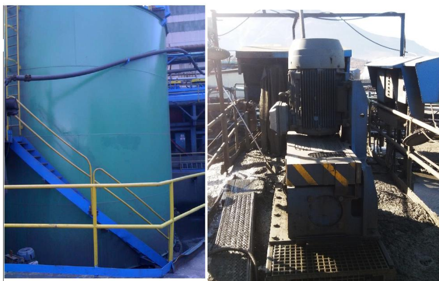
Figura 22 Estanque acondicionador y sistema motorreductor.
