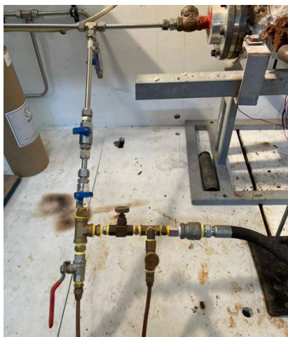
Figura 2.14: Conexiones de línea de vapor.
