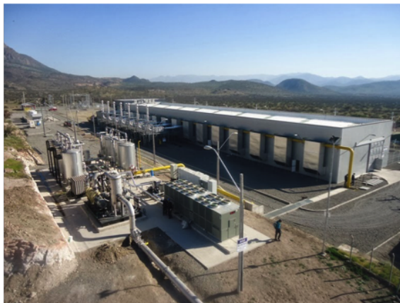
Figura 3.9: Central de Biogás Loma Los Colorados. (14)
