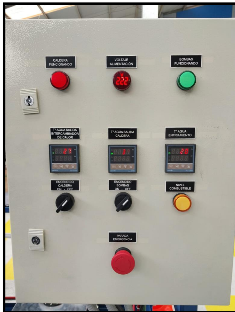
Figura 3-8. Tablero eléctrico industrial
