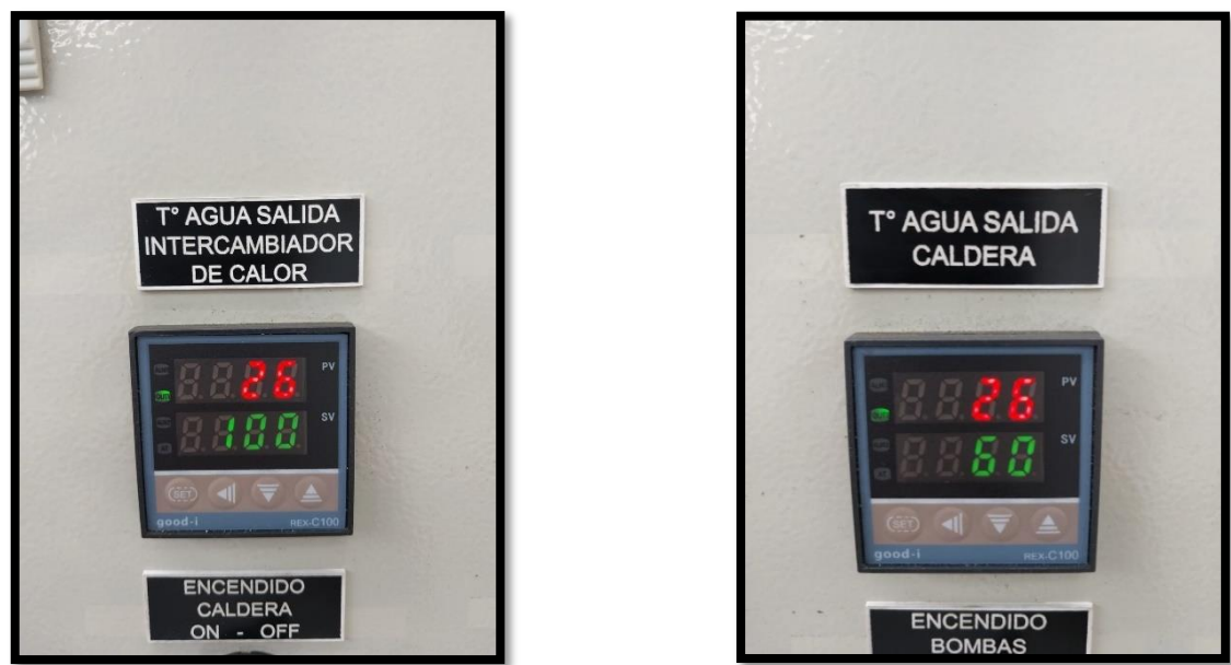
Figura 3-9. Indicador de temperatura de salida de la caldera e indicador de temperatura de salida de intercambiador de calor
