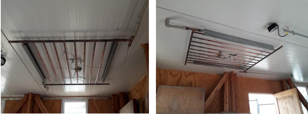
Figura 10 unidad terminal de cobre instalada en techo de casa fénix II, intercambia calor entre el agua enfriada y el ambiente de la casa.
