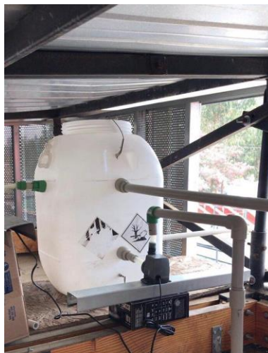
Figura 12 estanque de acumulación de 50 lt instalado en casa Fénix II.
