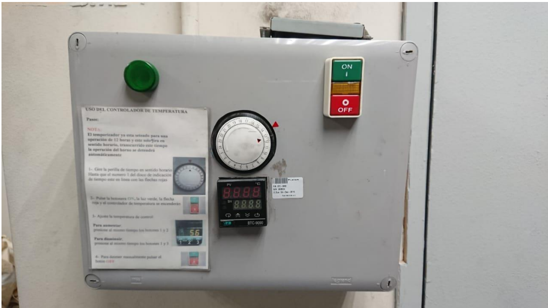
Figura 3-10 Controlador de temperatura del Horno.
