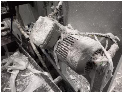
Figura 2.1 Motor afectado por polvo
