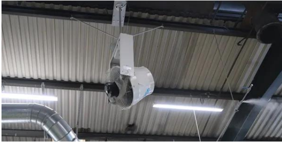
Fig 3.2A Circulaire Fan de Iuwa instalado.
