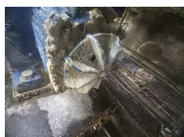
Fig. 2.4 Integridad del ventilador afectado
