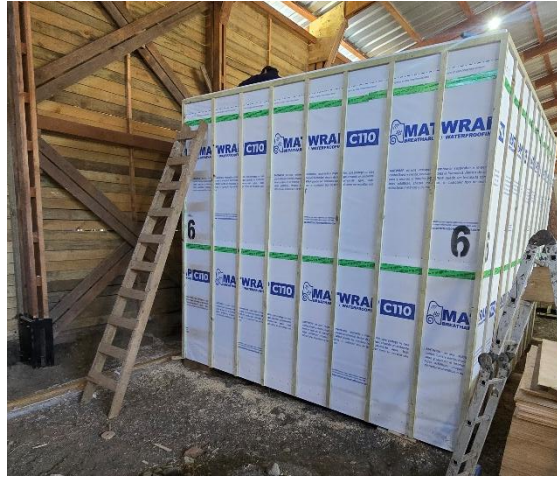
Figura 16. Módulo con fachada ventilada. FONDEF ID25I10634. 2025.
