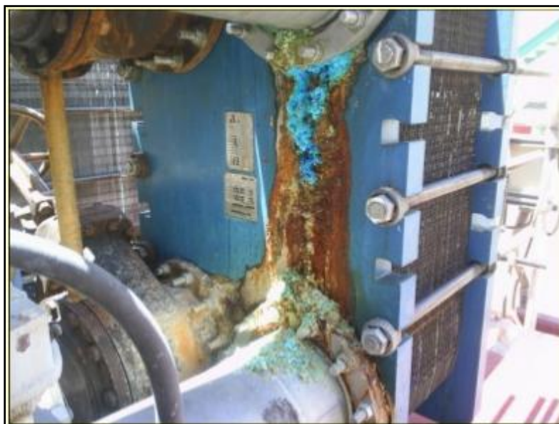
Figura N° 10. Falla por frame.
