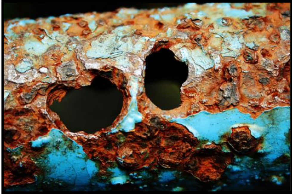
Figura N° 9. Corrosión en tubería. Fuente [14]
