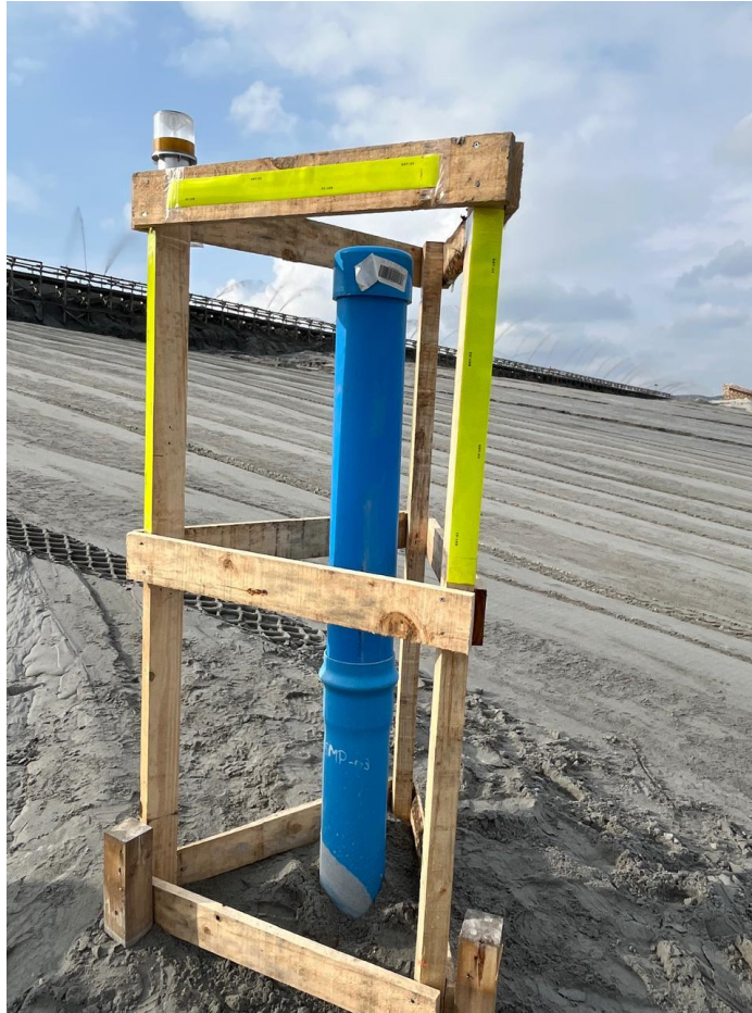
FIGURA 1.5 En la imagen se aprecia un piezómetro completo, con la estructura interna de tubos de PVC y el castillete instalado en uno de los nudos del muro de relave.
