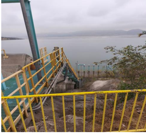
FIGURA 1.48. correspondiente a Torre N°5 de evacuación
