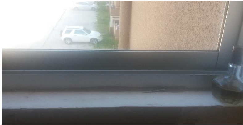
Figura 69: Desprendimiento pintura en borde de ventana depto. Q465.
