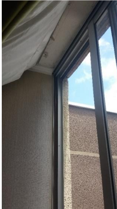
Figura 85: Hongos en cielo, borde de ventana living depto. R 469.
