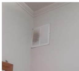
Figura 111: Rejilla de ventilación.
