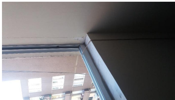
Figura 87: Desprendimiento de pintura borde de ventana dormitorio depto. U 481.
