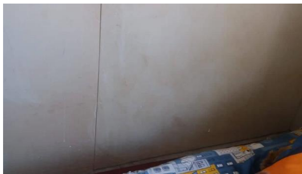
Figura 79: humedad en parte inferior del muro del dormitorio depto. L 445.
