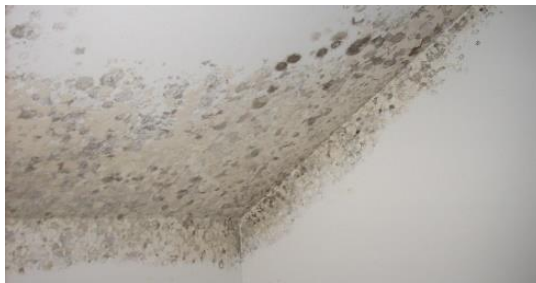
Figura 6: Manchas y moho en el techo.
