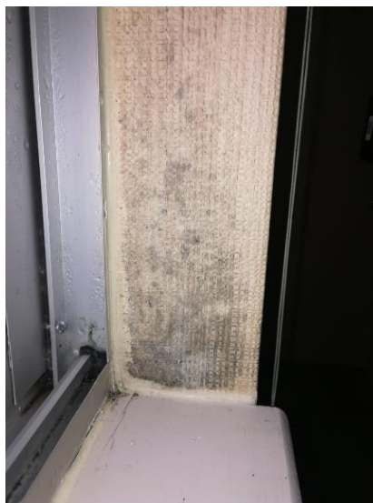
Figura 54: Hongos en borde de ventana (muro) de dormitorio depto. R 469.
