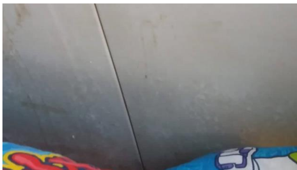
Figura 78: Humedad en parte inferior del muro del dormitorio depto. L 445.
