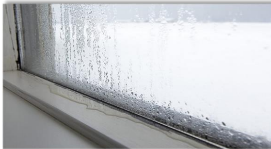
Figura 10: Goteras en las ventanas.
