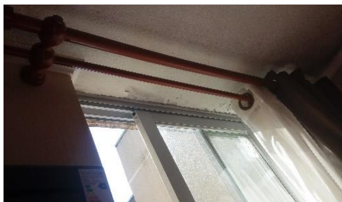
Figura 64: Desprendimiento de pintura en cielo de living, arriba de ventana depto F324.
