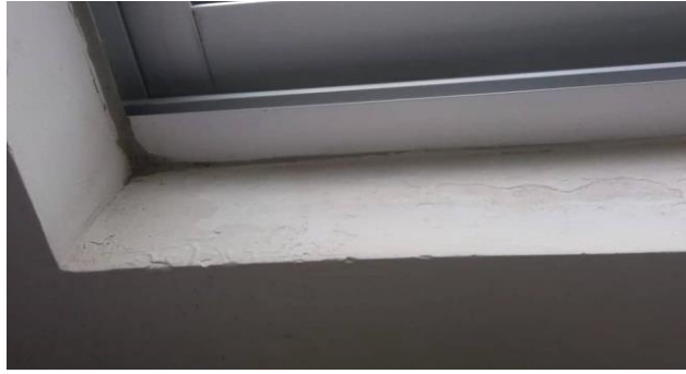
Figura 61: Humedad en el borde de ventana cocina depto. J 340.
