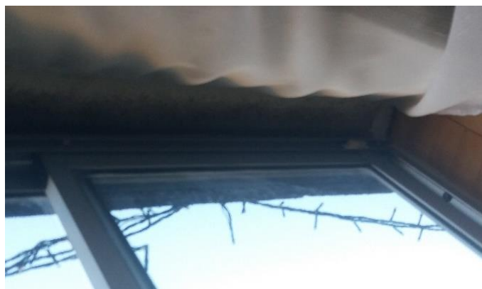
Figura 73: Hongos en cielo borde de ventana depto. G 125.
