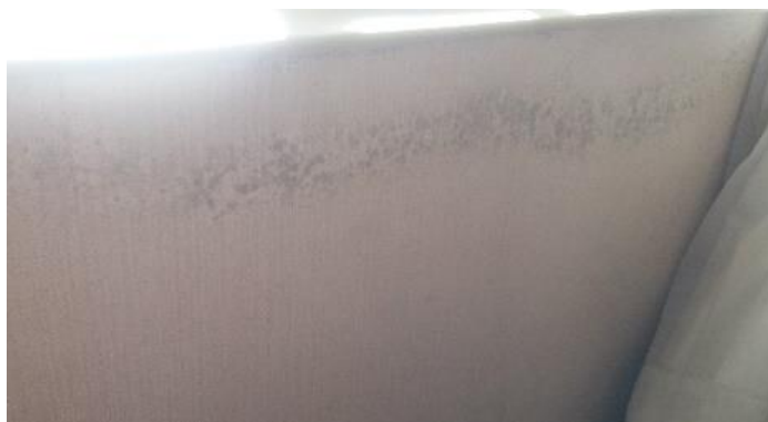
Figura 66: Hongos en muro dormitorio abajo de ventana depto. F 324.
