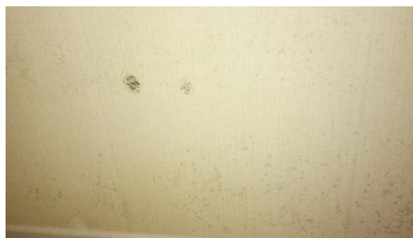
Figura 59: Hongos en muro dormitorio depto. C 109.
