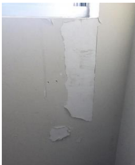
Figura 55: Desprendimiento de pintura dormitorio depto. I 334.
