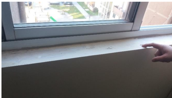
Figura 88: Desprendimiento pintura, borde de ventana dormitorio depto. U 481.
