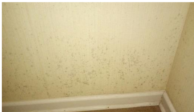
Figura 56: Hongos en muro de dormitorio depto. C 109.
