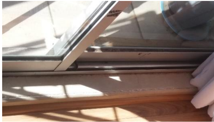
Figura 67: Humedad en ventanas living depto. A 302.
