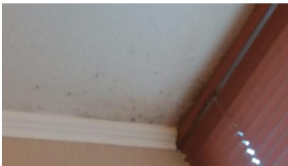
Figura 76: Hongos en cielo depto. N 155.
