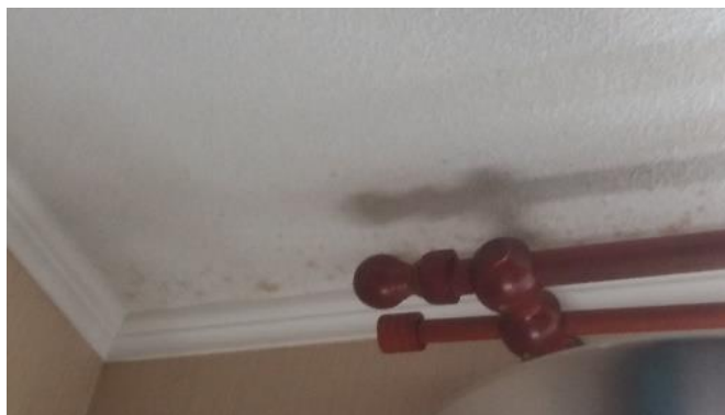
Figura 62: Hongos en cielo del living depto. F 324.
