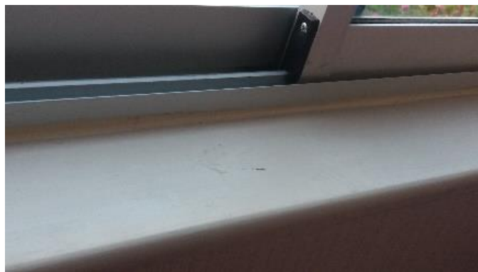
Figura 72: Desprendimiento de pintura borde de ventana depto. G 125.
