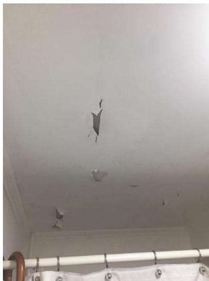
Figura 58: Desprendimiento de pintura en el cielo del baño depto. C 109.
