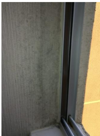
Figura 82: Hongos en borde de ventana (muro) de dormitorio depto. R 469.
