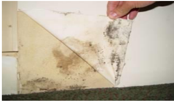
Figura 9: Desprendimiento papel mural.
