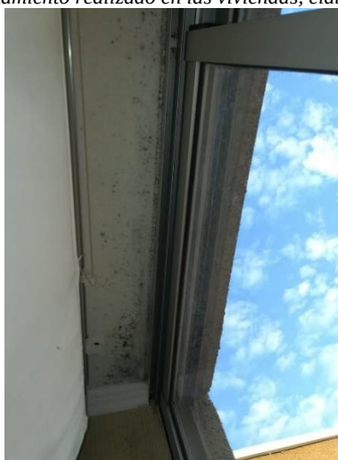
Figura 84: Hongos en cielo, borde de ventana depto. R 469.
