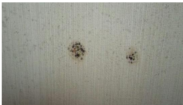
Figura 57: Hongos en dormitorios depto. C 109.
