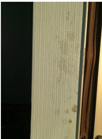
Figura 83: Hongos en borde ventana (muro) dormitorio depto. R 469.
