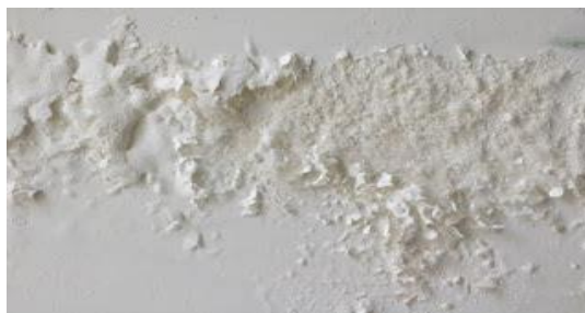
Figura 8: Desprendimiento de pintura.
