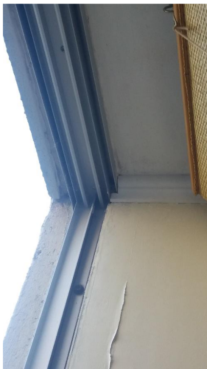
Figura 89: Desprendimiento de pintura alrededor de ventana dormitorio depto. U 481.
