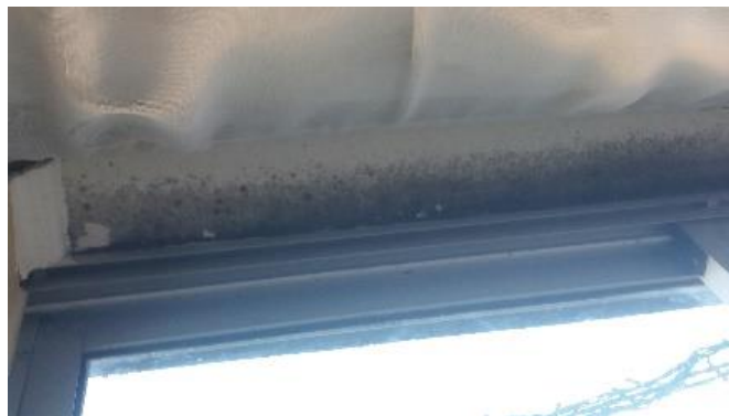
Figura 71: Hongos en cielo borde de ventana dormitorio depto. G 125.
