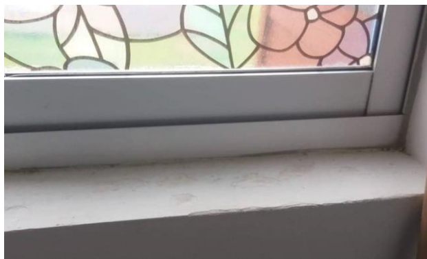
Figura 60: Humedad en borde de ventana cocina depto. J 340.
