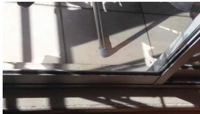
Figura 68: Humedad en ventanas living depto. A 302.
