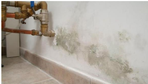
Figura 11: Humedad en tuberías.
