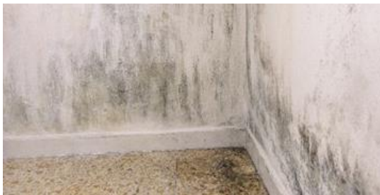
Figura 7: Manchas y moho en las paredes.
