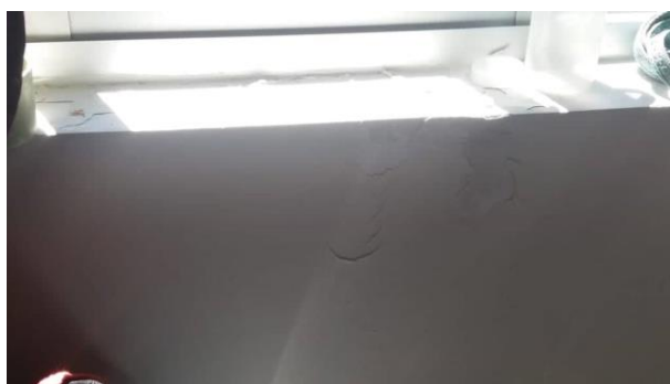
Figura 80: Desprendimiento de pintura en muro borde de ventana dormitorio depto. L 445.
