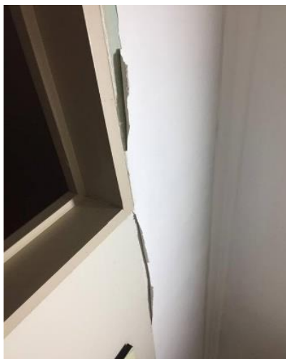
Figura 54: Desprendimiento papel mural en zona de ventana dormitorio, depto. I 334.
