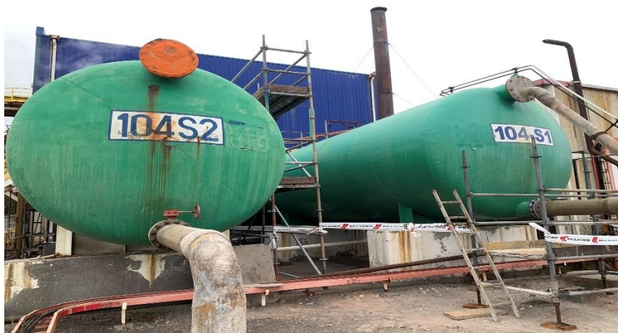
Fig. 8 Tanques cilíndricos horizontales.
