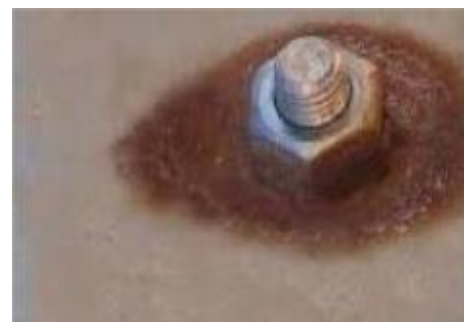
Fig. 16 Accesorio con corrosión galvánica.
