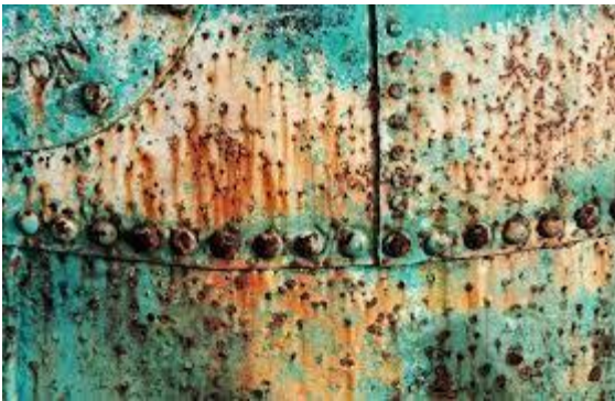
Fig. 13 Tanque afectado por corrosión por picaduras.
