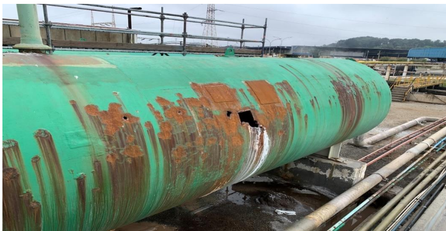
Fig. 11 Pared tanque de almacenamiento con perforaciones pasantes.
