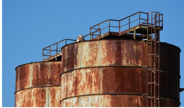
Fig. 20 Daño por corrosión en el exterior de un tanque.
