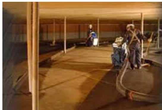
Fig. 19 Corrosión techo interno flotante.
