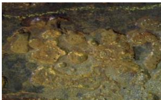
Fig. 22 Corrosión localizada en fondo del tanque.
