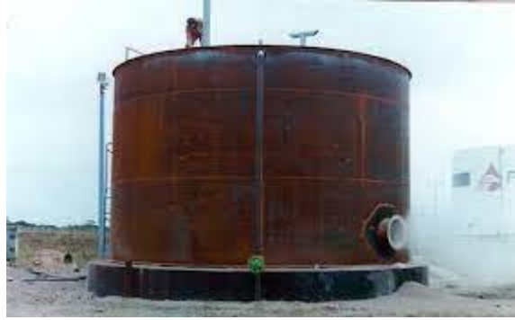
Fig. 12 Tanque afectado por corrosión uniforme.
