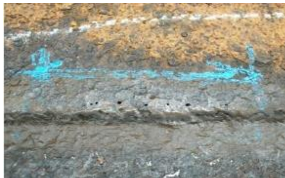
Fig. 17 Corrosión fondo del tanque.
