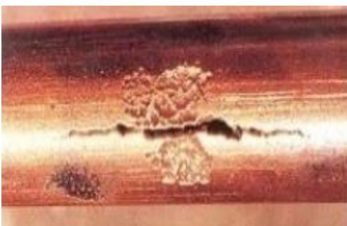
Fig. 15 Accesorio corroído por esfuerzo.
