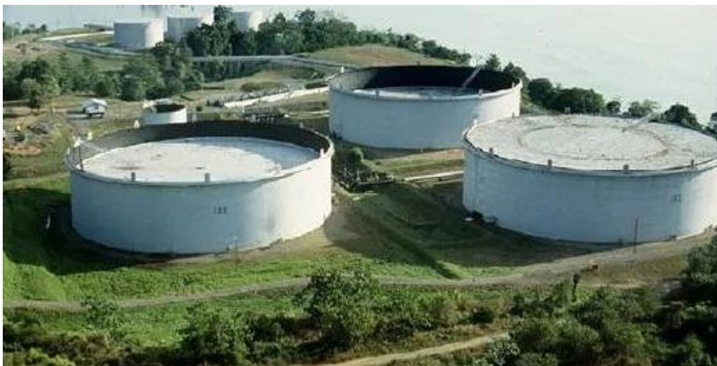
Fig. 4 Tanque con techos flotantes.
