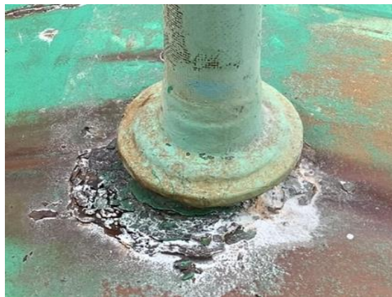
Fig. 21 Unión soldada corroída.
