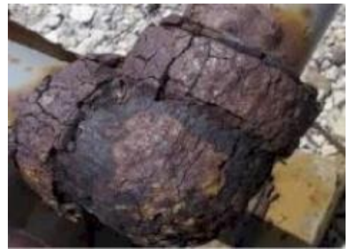
Fig. 14 Accesorios corroídos por la erosión.
