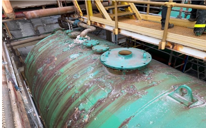
Fig. 23 Disminución de espesor en pared.
