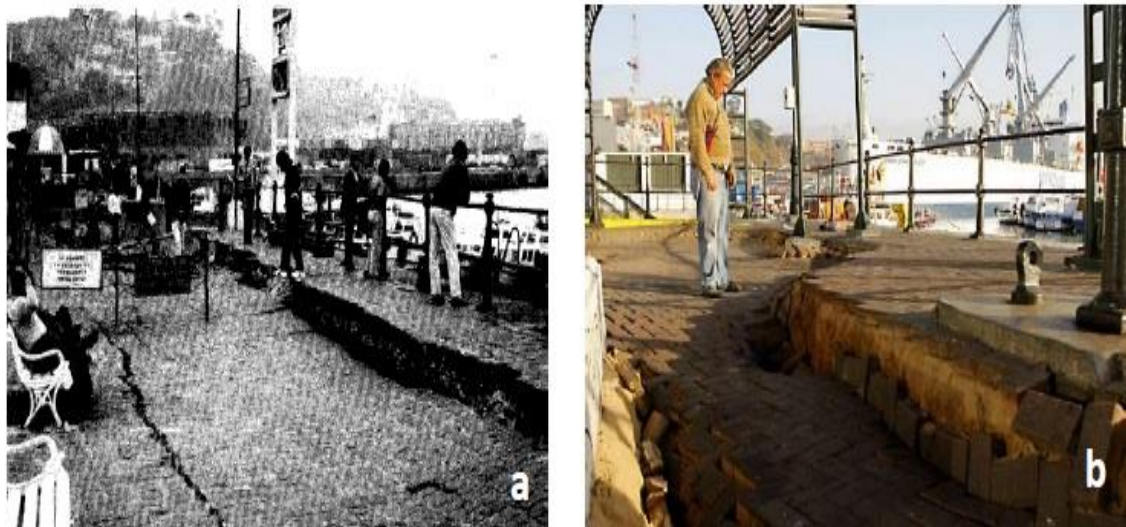
Figura 18: Formación de grietas y asentamientos del terreno en Valparaíso posterior al terremoto de 1985 (a) y 2010 (b) respectivamente.
