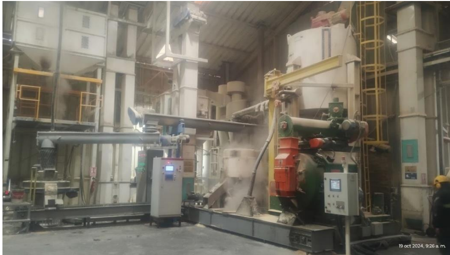
Figura 1-16. Zona de prensas
