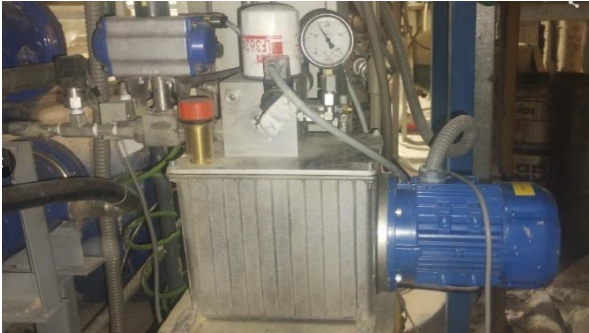
Figura 3-8. Sistema hidráulico (central hidráulica). Fuente: autoría propia. Imagen registrada en terreno.
