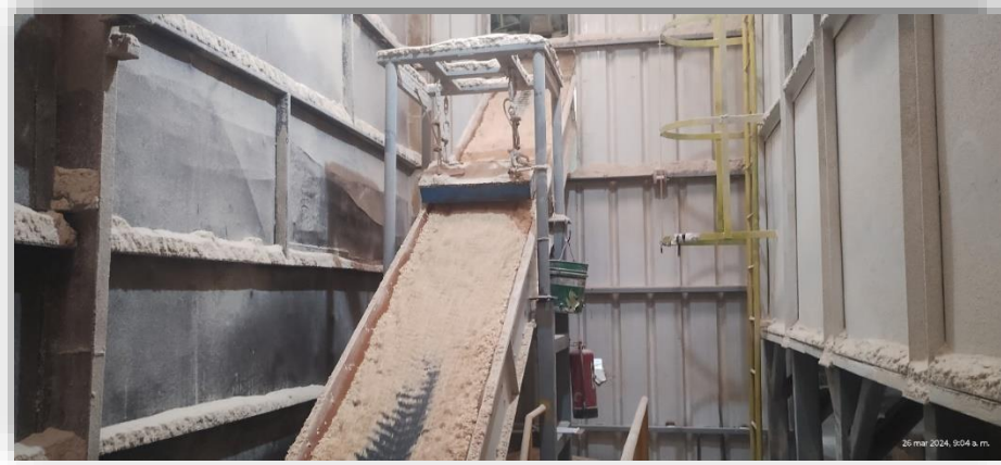
Figura 1-4. Correa transportadora, CT-01. Fuente: Autoría propia, imagen registrada en terreno.
