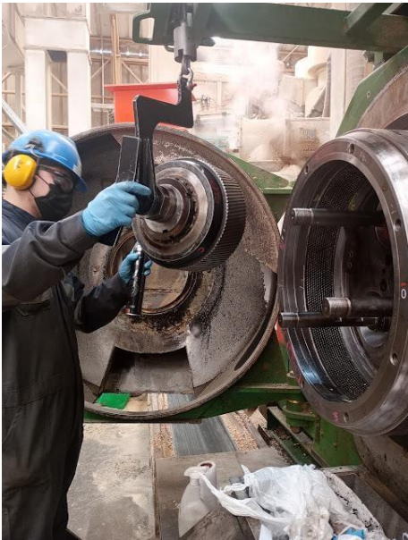
Figura 3-21. Imagen de montaje de rodillos. Fuente: Autoría propia, imagen registrada en mantenimiento a prensa Mabrik
