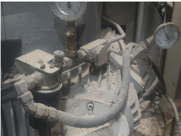
Figura 3-15. Dispositivos de medición de parámetros de aceite lubricador. Fuente: Autoría propia. Imagen registrada en terreno.
