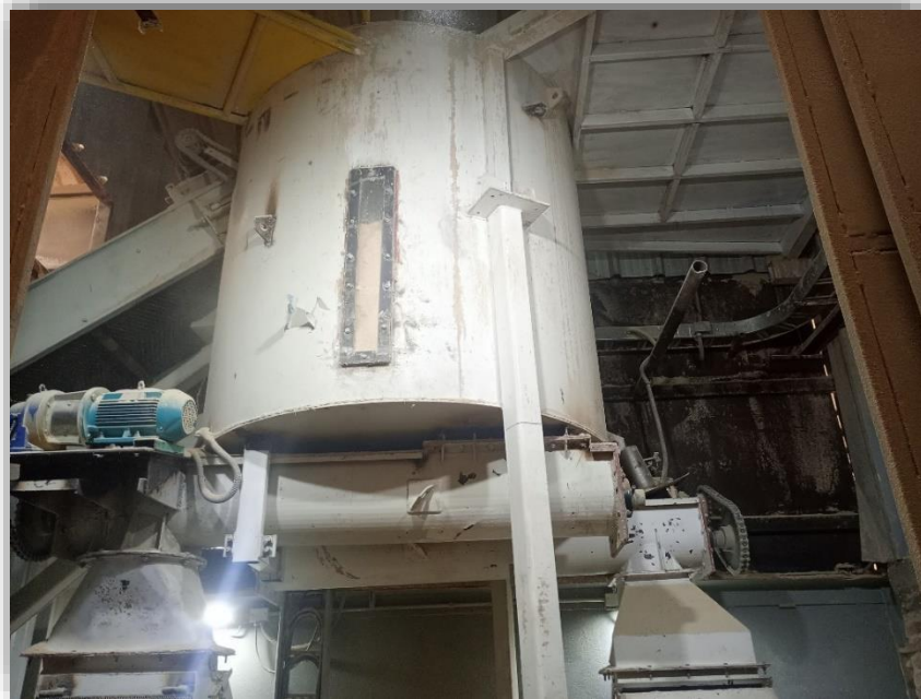
Figura 1-5. Estanque revolvedor y tornillos de alimentación a molinos n°1 y n°2. Fuente: Autoría propia, imagen registrada en terreno.
