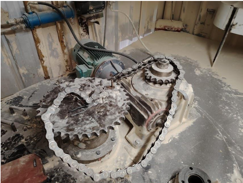
Figura 3-31. Vista parte superior del tanque revolvedor. Fuente: Autoría propia. Imagen registrada desde instalaciones.
