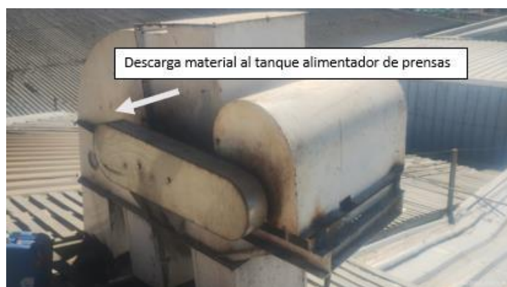
Figura 1-15. Vista superior de elevador 2
