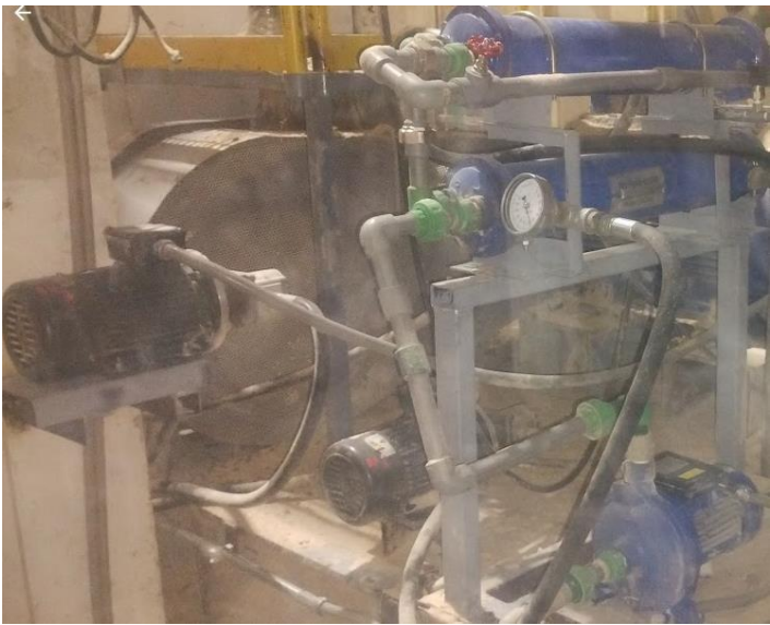
Figura 3-14. Sistema enfriador de aceite lubricador de engranajes de prensa Kahl. Fuente: Autoría propia. Imagen registrada en terreno.
