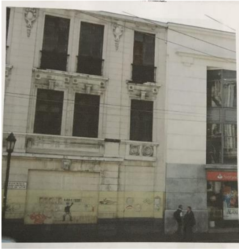
Figura 1-10. Vista ampliada de daño de la fachada de la foto anterior.
