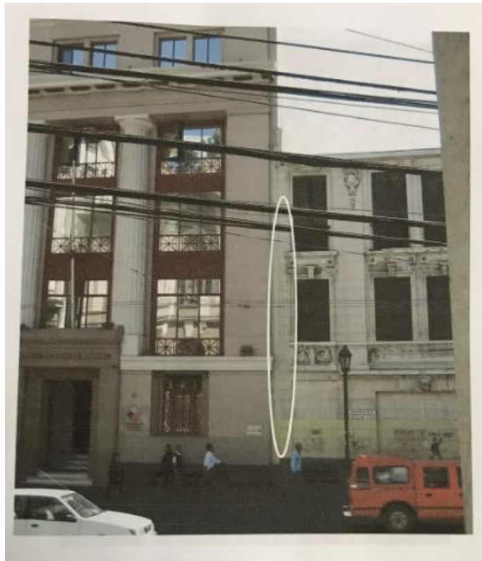
Figura 1-8. Vista Fachada por Calle Esmeralda del edificio donde se aprecia fisura vertical del revestimiento exterior.
