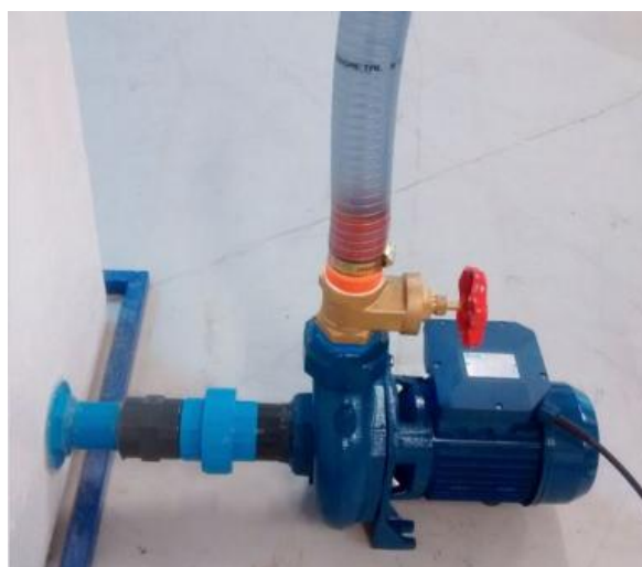
Figura 5.16 Conexiones junto a la bomba
