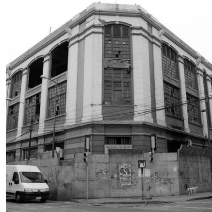
Figura 16: Mercado Puerto con daños estructurales producto del terremoto de 2010.
