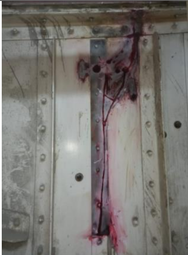
Imagen N°39 “Grieta en pared de harnero”
