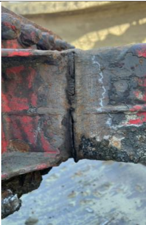
Imagen N°45 “Grieta en estructura”
