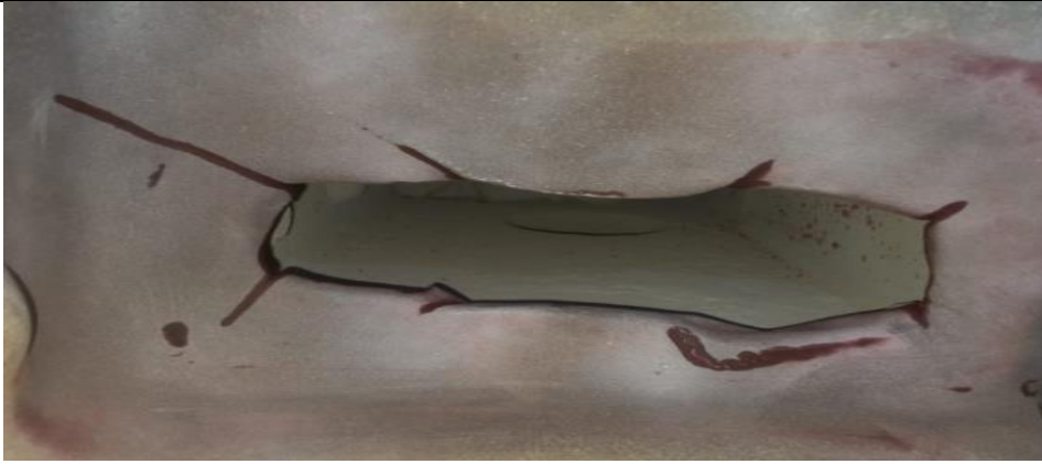
Imagen N°38 “Rotura en viga interna”
