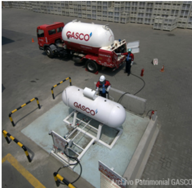
Figura 2.9: Abastecimiento tanque GLP para uso industrial.
