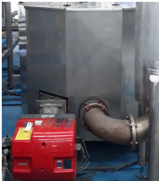
Figura 3.3: Quemador de gas conectado al estanque de almacenamiento y tubo de salida de gases de escape
