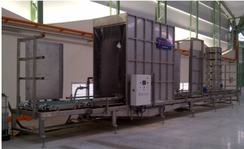
Figura 2.3: Drencher de cadenas
