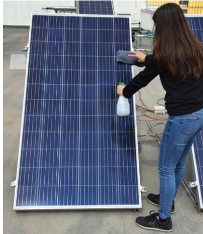
Figura 6-2: Procedimiento de limpieza de módulos fotovoltaicos.
