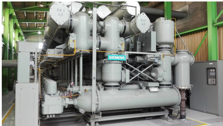
Figura 2.3: Subestación GIS central Tocopilla, I_k :31,5kA, I_n :1600A, V_n :220kV .
