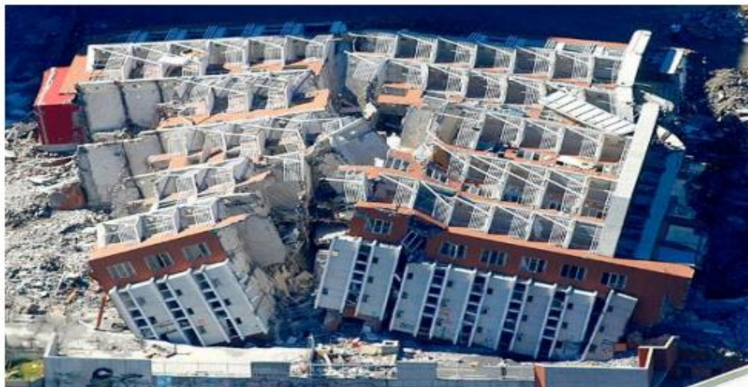
Figura 2.3: Edificio Alto Río Colapsado post terremoto 27 febrero 2010
