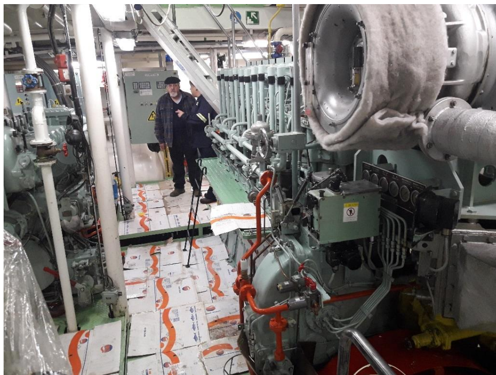
Ilustración 3-31: Primer piso Sala de máquinas motonave AKASAKA
