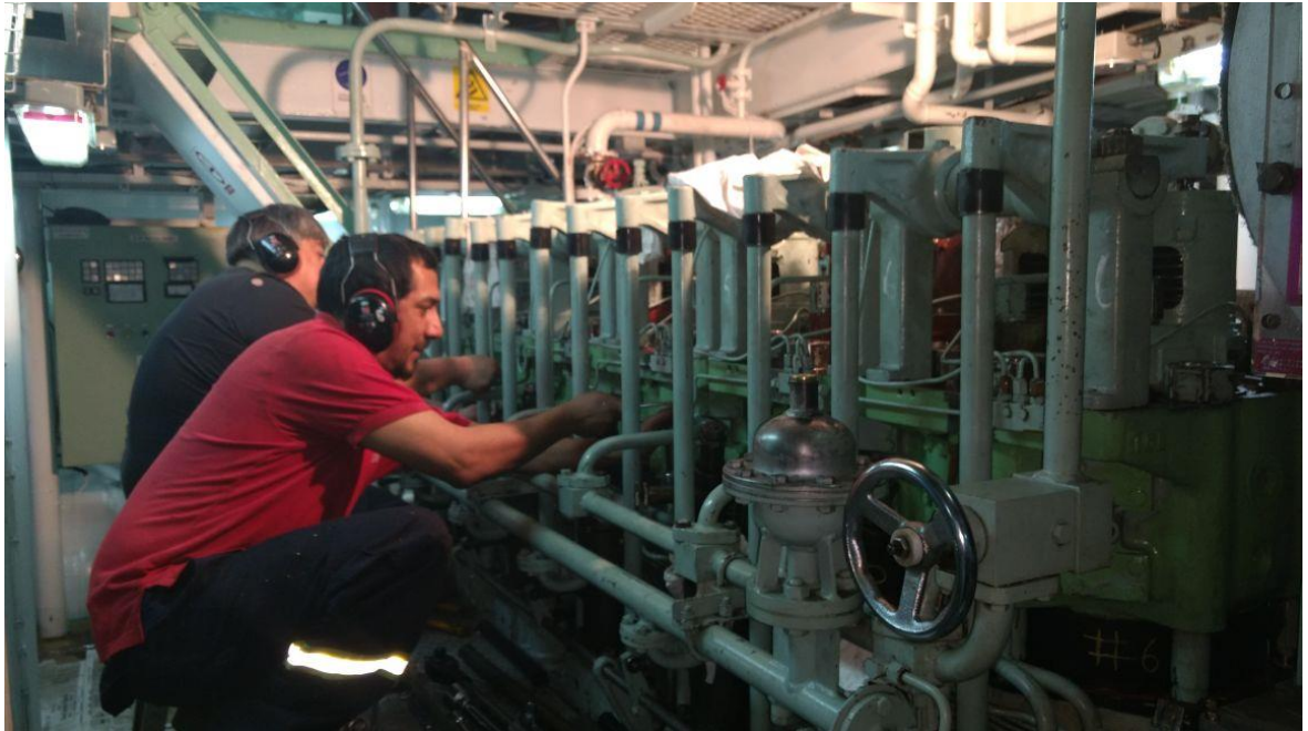
Ilustración 2-28: Uso de protectores auriculares en sala de maquinas
