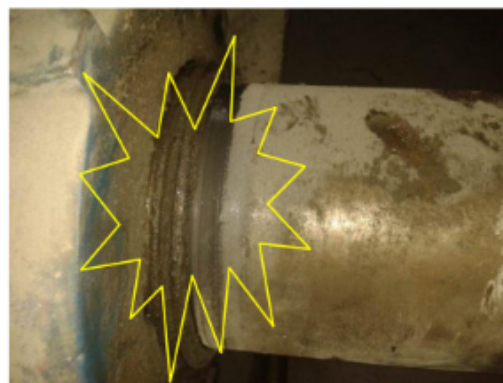
Figura 2.6: Evidencias de desplazamiento de eje y daño asociado en MOBO5.
