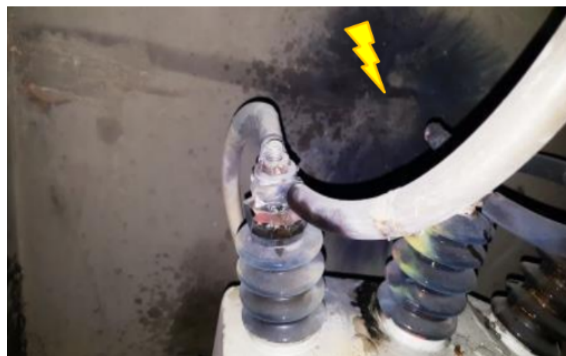
Figura 2.7: Evento monofásico a tierra en MOBO4 por terminal suelto en circuito asociado.
