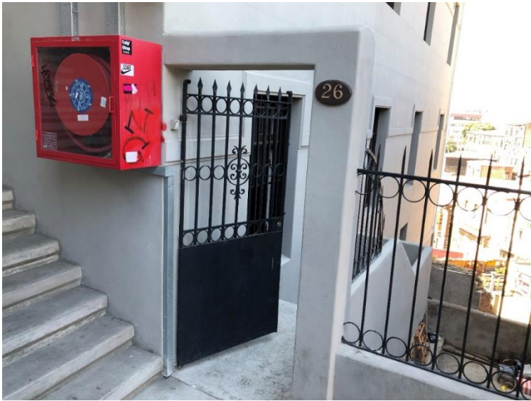
(5) Sistema de extinción de incendio en el interior del pasaje Bavestrello
