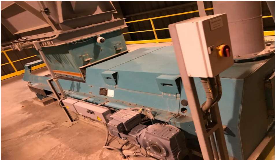
Fuente: Elaboración propia en terreno correa transportadora
