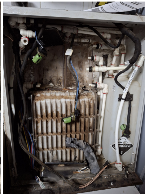
((b)) Equipo con pérdida total
