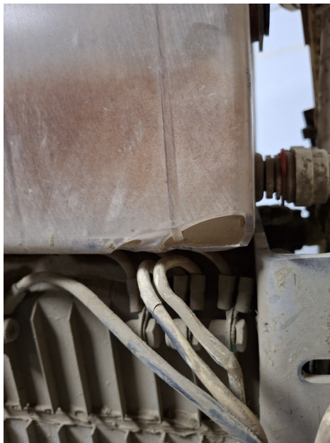
((a)) Fuga del tanque de fluido principal
