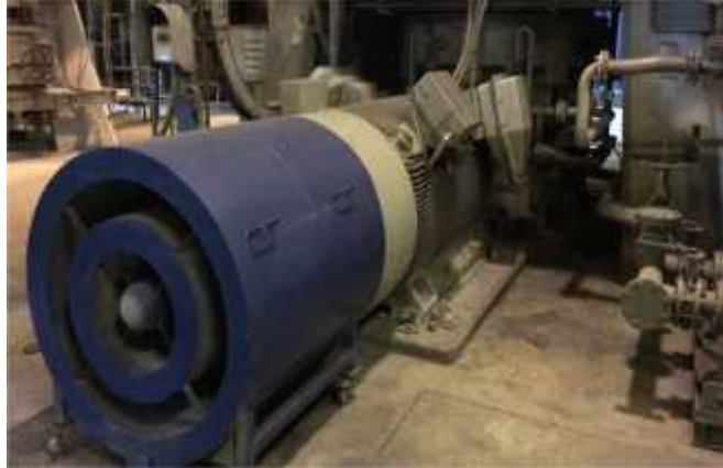
Figura 4- 2 Motor eléctrico www.enel.cl
