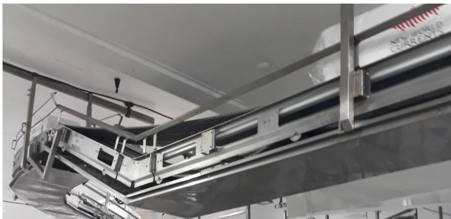
Figura 28: Cinta AFE13 durante operación, sin carga.
