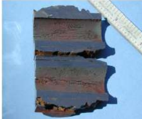
Figura 4. Fatiga por corrosión en tubos de caldera. Fuente. IMPACT OF PLANT CYCLING ON AVAILABILITY. POWER2015-49359
