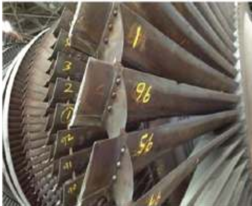
Figura 5. Daño en alabes TV producto desprendimiento óxidos en tubos caldera Fuente: IMPACT OF PLANT CYCLING ON AVAILABILITY. POWER2015-49359
