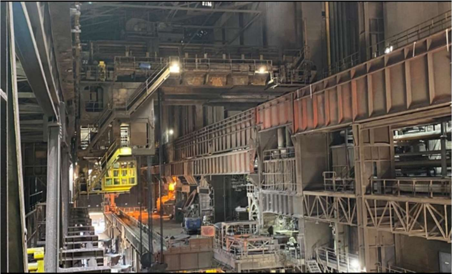
Figura 3- 2: Grúa puente 11 175/45 Ton. Imagen Propia
