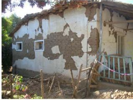
Desprendimiento de estuco (G2) en Lolol.
