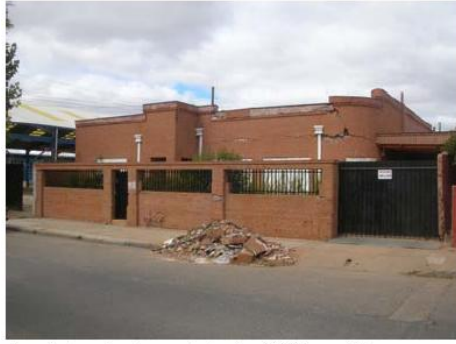
Agrietamiento antetecho (G2) en Cauquenes
