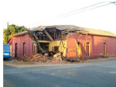
Caída de dos muros (G5) en Parral.
