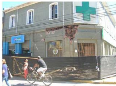
Caída de parte de un muro (G4) en Angol.
