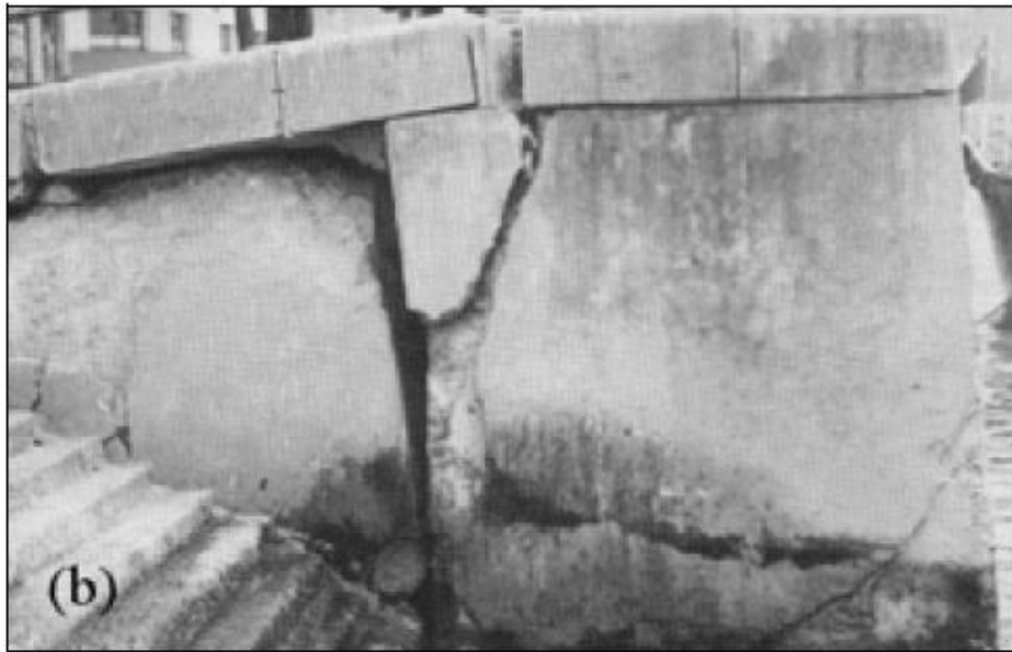
Figura 5.6. Falla de estructura de contención y hundimiento de rellenos en muelle Prat (Troncoso, J. 1992).
