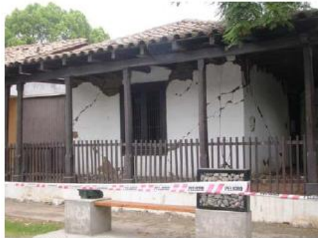
Grietas diagonales en muro (G3) en Pichidegua.
