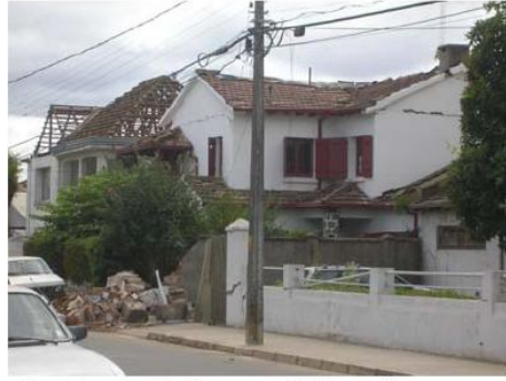
Agrietamiento tímpano (G2) en Cauquenes
