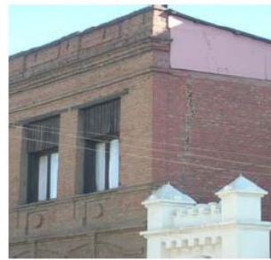
Grieta en encuentro de muros (G2) en Santiago
