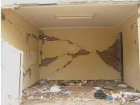
Grietas diagonales en muro (G3) en Cauquenes
