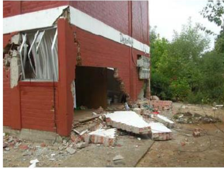
Caída de parte de un muro y grieta en zona crítica del pilar (G5) en un edificio de 3 pisos en Cauquenes.
