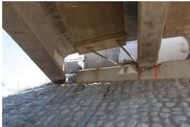
Figura 2.14 - Pérdida de Apoyo de la Viga Sur del Estribo Oeste del Paso Inferior Atravieso Las Mercedes durante el Terremoto del Maule (2010). Fuente: [6].
