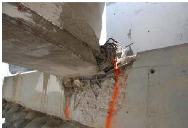
Figura 2.15 - Daño en la Viga Central del Estribo Oeste del Paso Inferior Atravieso Las Mercedes durante el Terremoto del Maule (2010). Fuente: [6].
