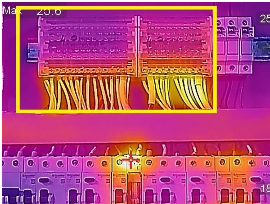
Figura 3-7. Toma termográfica a una barra repartidora Fuente: Elaboración propia
