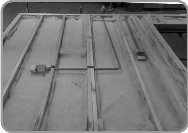
Instalación eléctricas - estación 4
