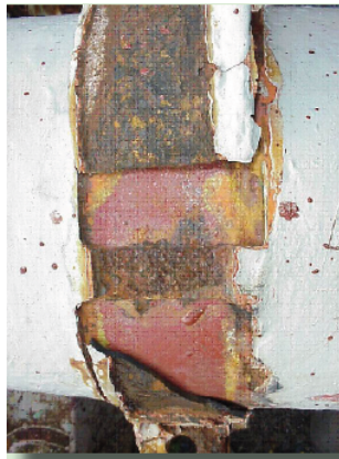
Figura 4.11: Corrosión externa bajo las abrazaderas de tuberías [40].
