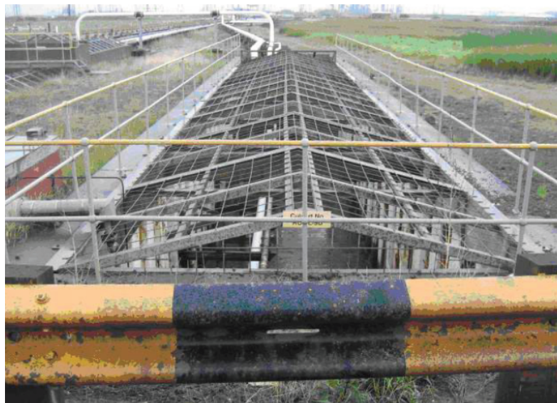
Figura 4.14: Ejemplo de barrera de seguridad con construcción de jaula, que protege tuberías en una alcantarilla [40].
