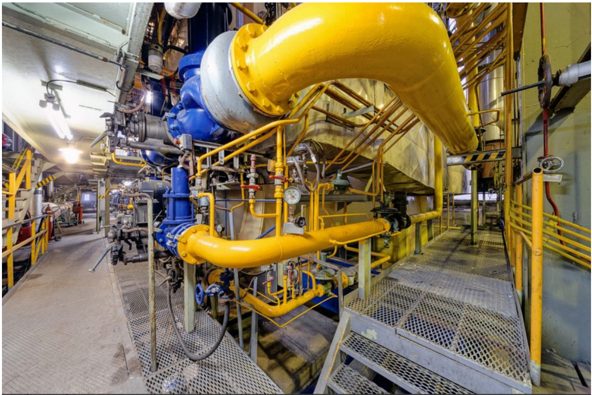
Figura 4.1: Tuberías de amoníaco [81].
