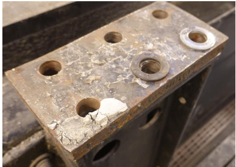
Figura 111: Placa metálica de fijación para zapato de apoyo junto a sistema de bolillas utilizado
