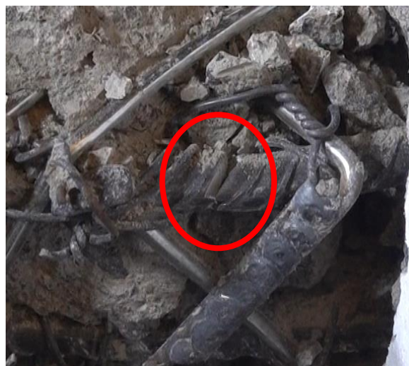
Figura 51: Fractura del refuerzo longitudinal, comienzo de segundo ciclo de 35 [mm]
