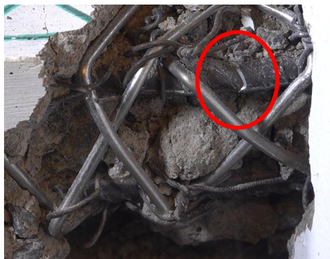
Figura 60: Fractura del refuerzo longitudinal, primer ciclo de 35 [mm]
