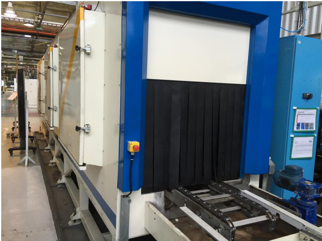
Ilustración 10.1.- Estación de lavado actual. (Fuente: fotografía real)
