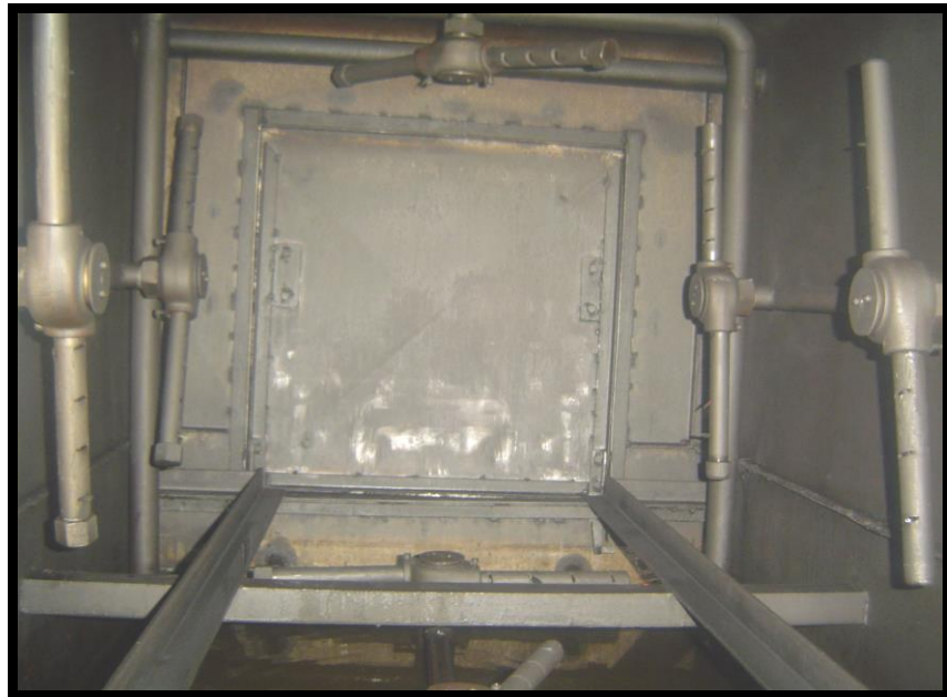
Ilustración 6.2.- Interior Máquina lavadora. (Fuente: fotografía real, línea de producción)
