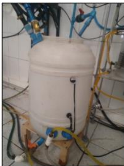
Figura B.1 Tanque TK-103.
